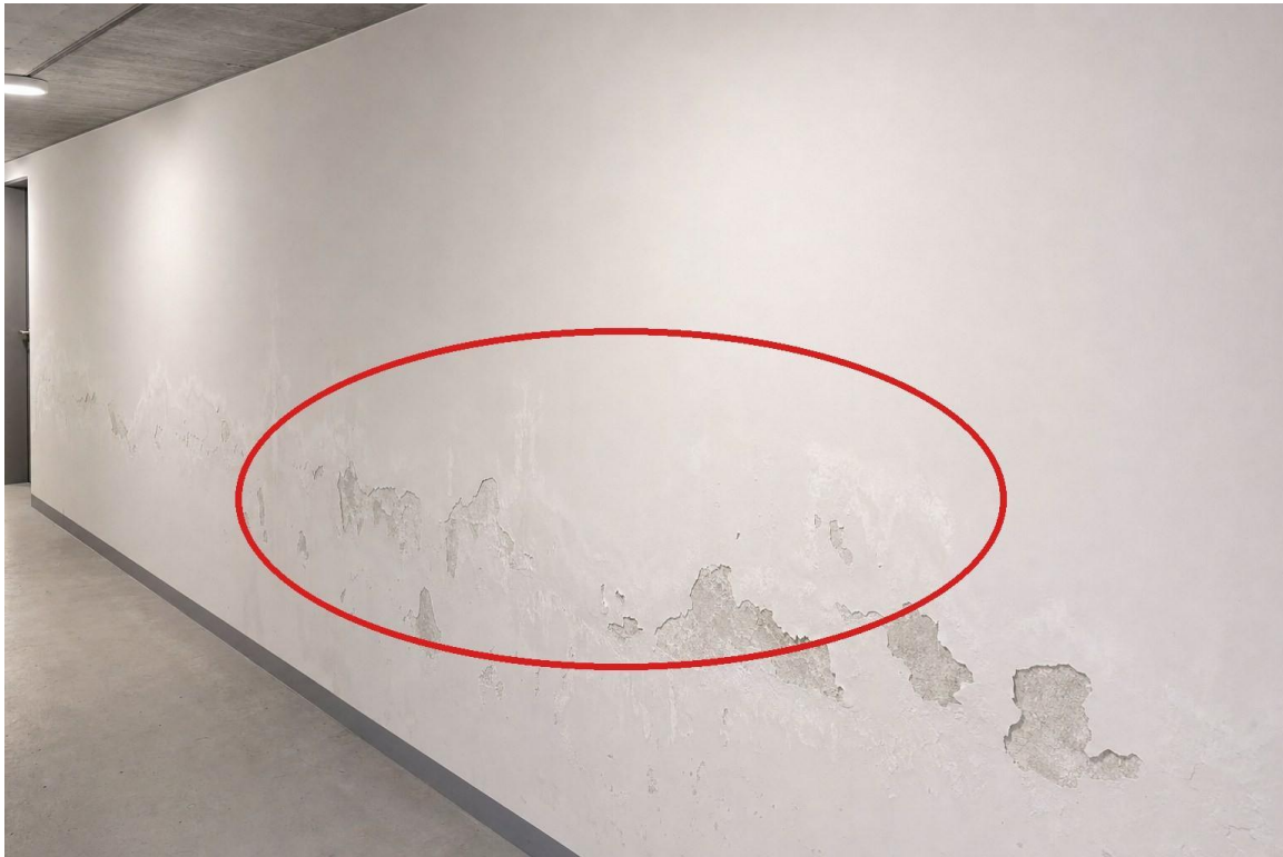
Salzausblühungen und Putzabplatzungen Kellerwand
