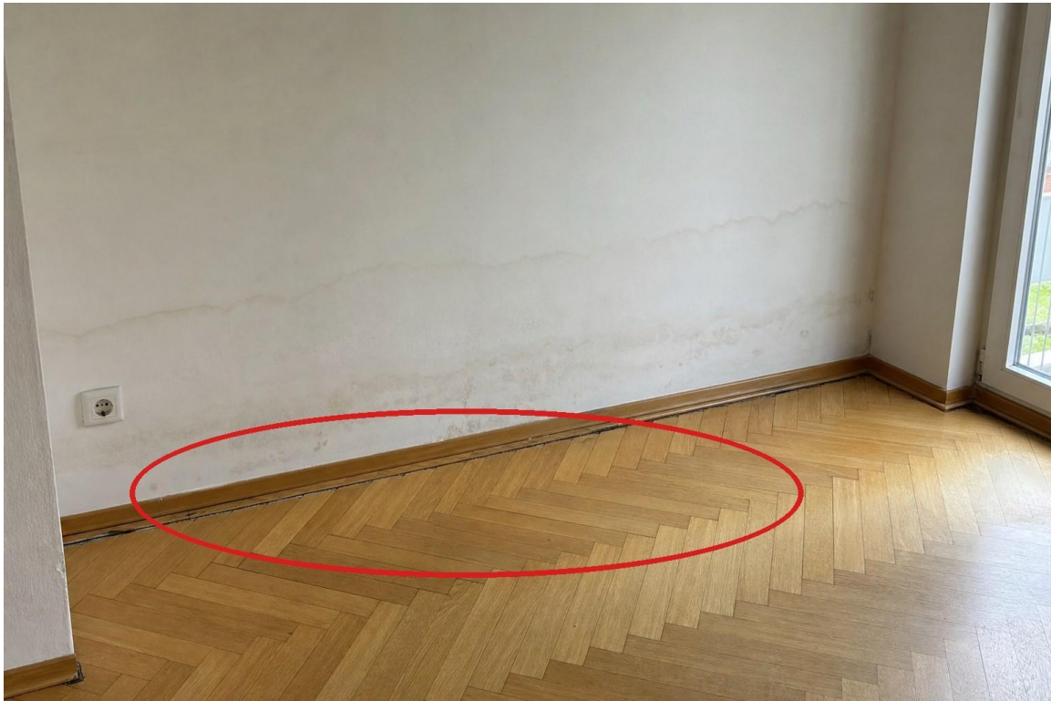
Feuchtehorizont Sockelzone Top 11 / Anschlussfuge TG-Rampe offen
