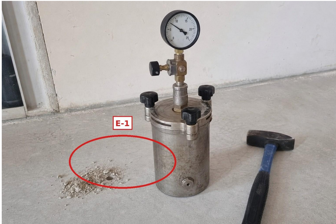
Erhöhte Estrichfeuchte Top 2 wandnahe Zone
