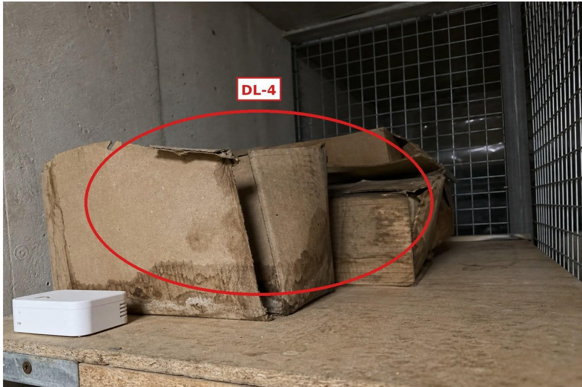
Erhöhte Luftfeuchte Kellerabteile 3–5
