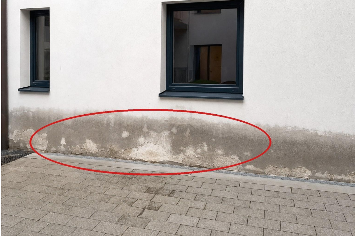
Durchfeuchtung Sockelzone Hoffassade
