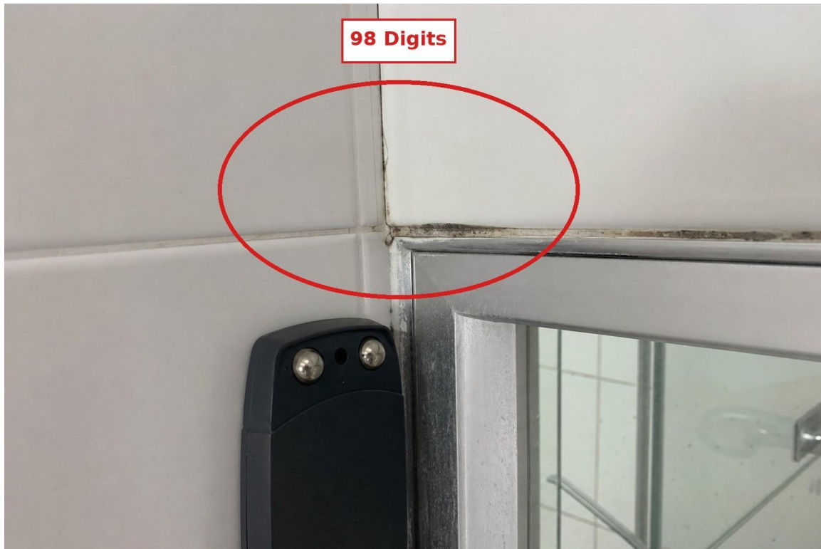
Kapazitiv erhöhte Werte Bad-Außenecke Top 5
