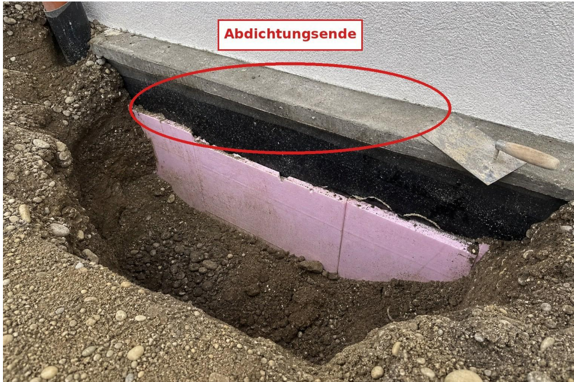
Vertikalabdichtung endet unter Geländeniveau
